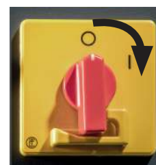
Włączanie wyłącznika głównego
